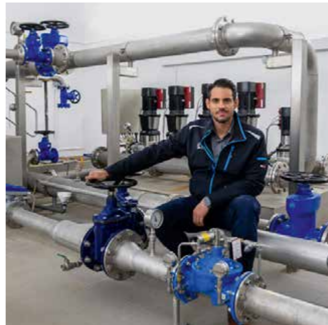
Christoph Pfaff freut sich über die Realisierung der Versorgungslösung, die mittels eines mechanischen Druckregelventils ganz ohne Strom funktioniert.
