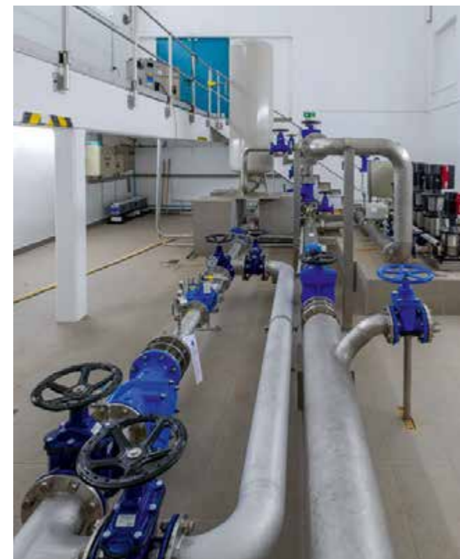
Ansicht der gesamten Druckanlagenerhöhung in Zeppelinheim.
